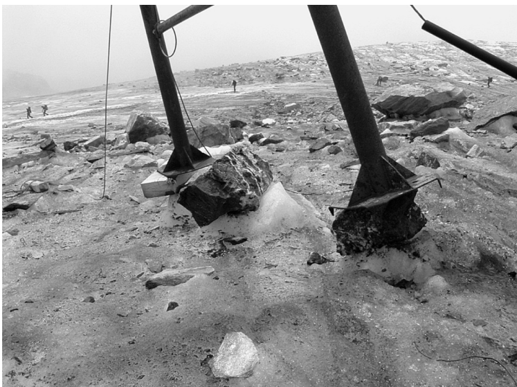
Foto 7: ormai precarie le condizioni di stabilità dei tralicci della scivola Roccette ancora presenti sulla superficie glaciale. Lo sci estivo sul Ghiacciaio di Indren è ormai un lontano ricordo. (P. Piccini).
